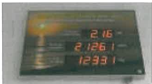
Pannello posto alle scuole elementari che visualizza l'energia prodotta dall'impianto fotovoltaico.
